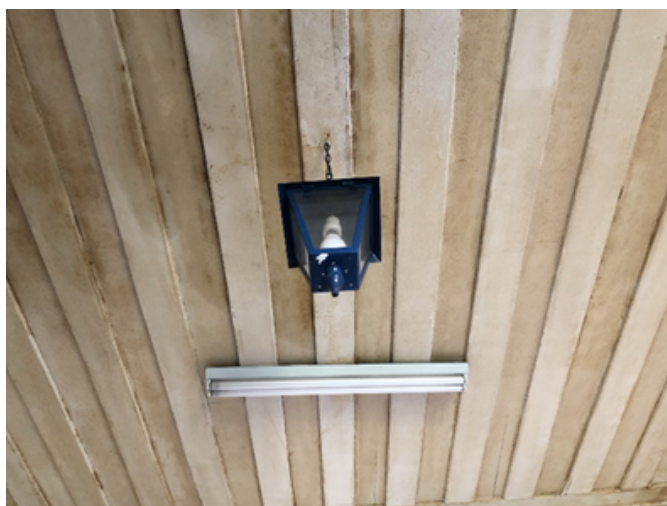
Antigo Sistema de Iluminação:
